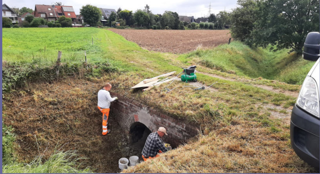
Die Brücke über den Oelvebach wurde Ende August mit 120 kg Beton repariert.
